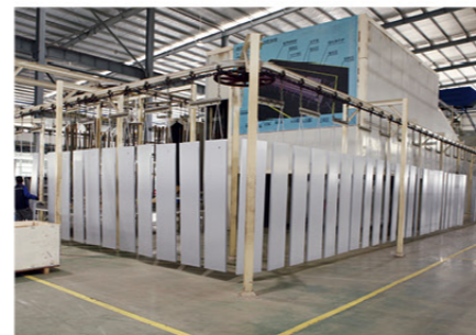
德国瓦格纳自动喷涂生产线 Germany WAGNER automatic spraying production line
